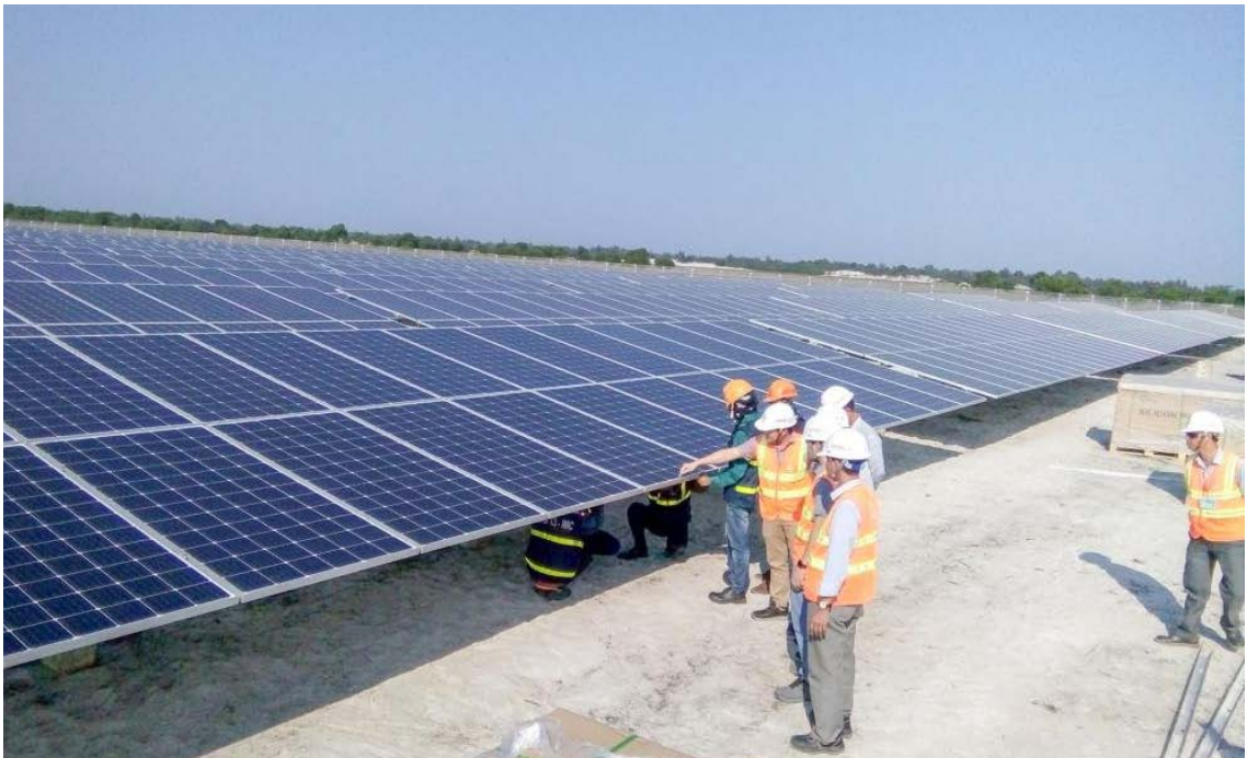
Đóng điện thành công Nhà máy điện mặt trời LIG tại Gio Linh, Quảng Trị. Ảnh: Hồ Nguyên Kha
