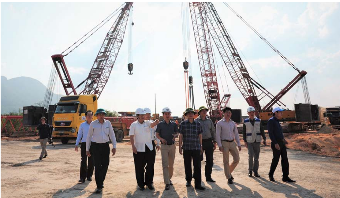
Phó Chủ tịch Thường trực UBND tỉnh Hà Sỹ Đồng kiểm tra tiến độ thi công Nhà máy điện gió Gelex 1. Ảnh: Trần Tuyên
