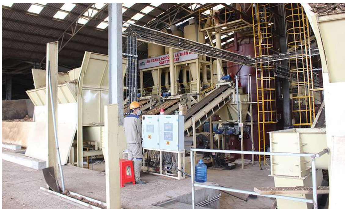
Ứng dụng công nghệ tiên tiến, máy móc, thiết bị hiện đại tại Nhà máy viên nén năng lượng Cam Lộ. Ảnh: Nguyễn Thị Hải Châu
