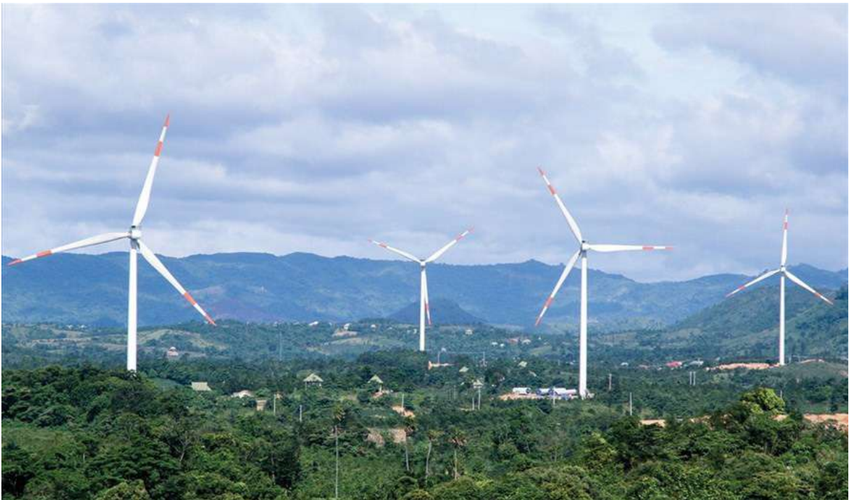
Tua-bin tại Điện gió Hướng Linh đang hoạt động. Ảnh: https://laodong.vn
